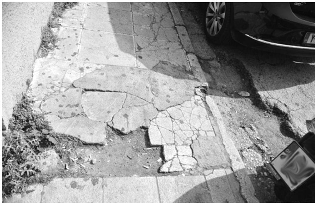
Νέο Ψυχικό. Μετά από τόσα έργα βιτρίνας, ιδού η κατάσταση των πεζοδρομίων (Στρατήγη και Ψυχάρη)
