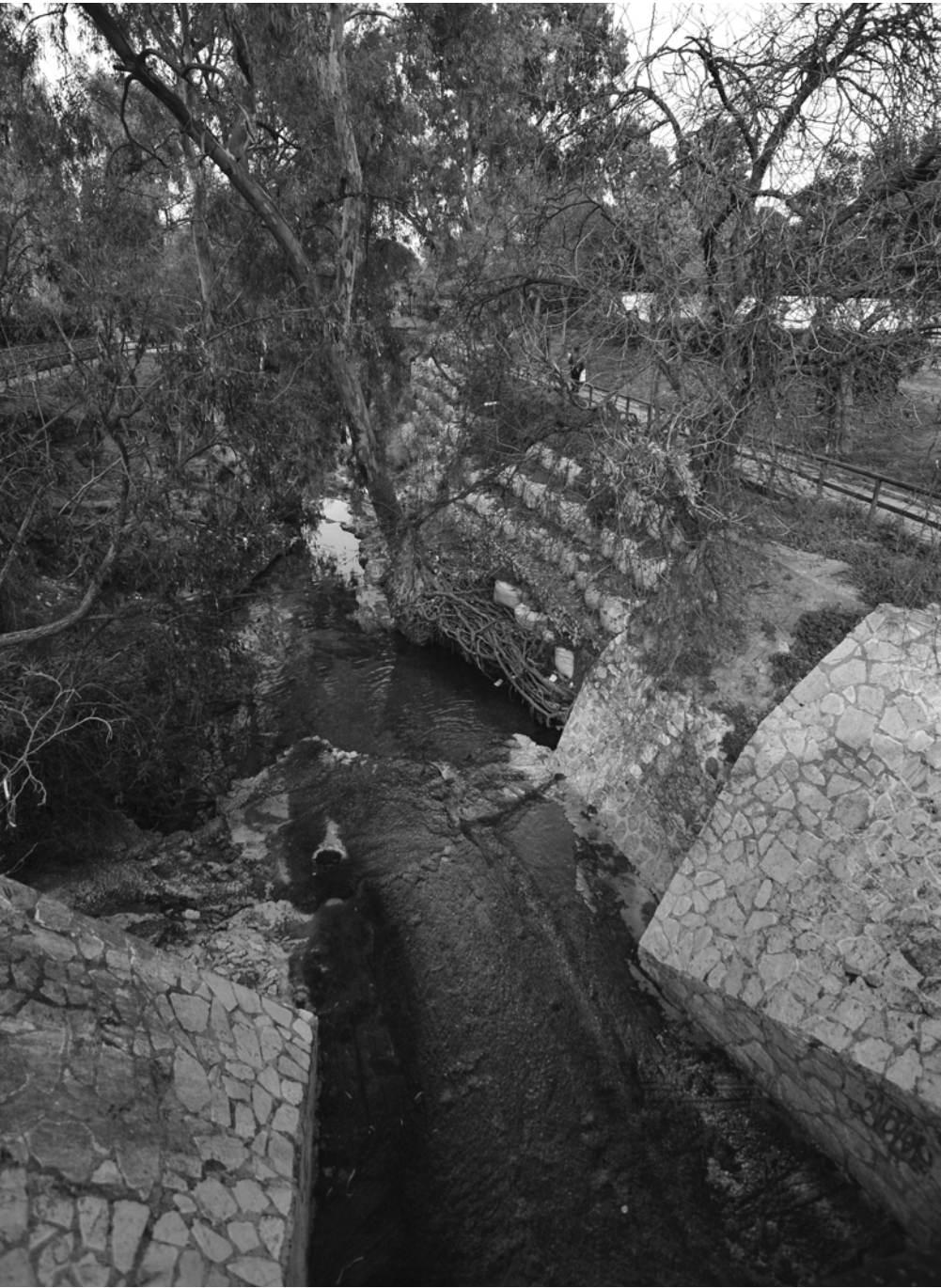
Μια άποψη του ρέματος στη Φιλοθέη. Τα απαιτούμενα έργα υποδομής δεν έχουν γίνει, με αποτέλεσμα να υπάρχουν μεγάλοι κίνδυνοι για τις παραρεμάτιες υποδομές (σχολεία, γυμναστήριο, κατοικίες)
